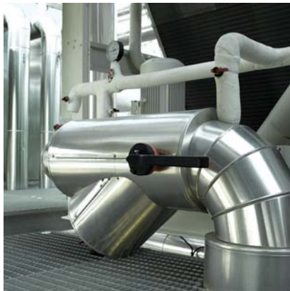
Применение в установках кондиционирования
