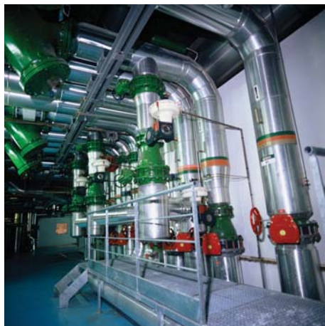
Пример технологической установки, использующей функции, присущие только системам управления зданиями
