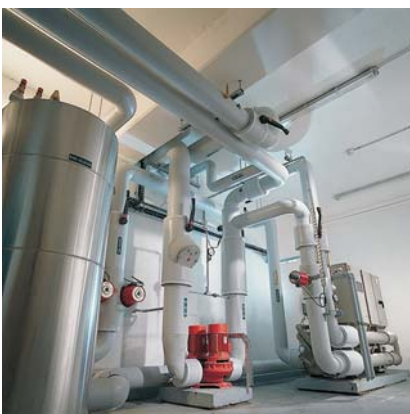
Применение в насосных агрегатах
